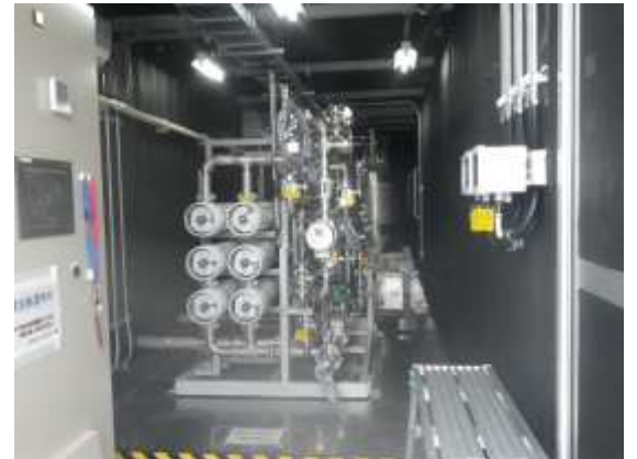
地下水ドレン前処理設備の内部
