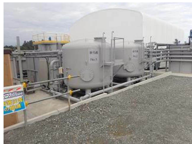
浸出水処理施設の設置状況の確認
