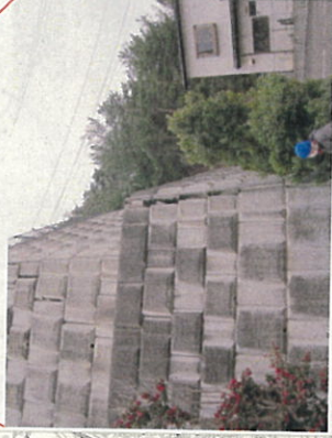
○部 擁壁破壊状況
