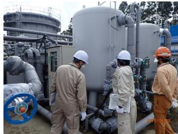
浸出水処理施設の稼働状況の確認
