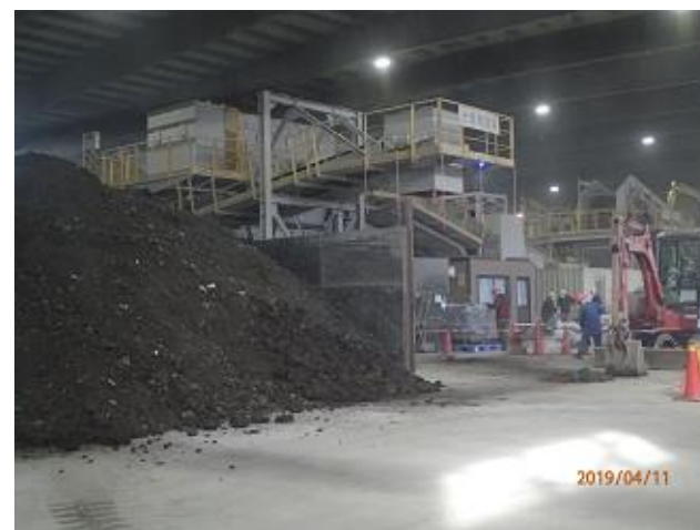
受入・分別施設の稼働状況の確認
