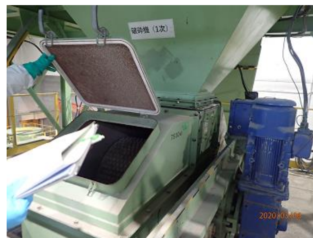
固型化施設(破砕機)の確認
