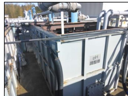
【PH調整槽外観】
