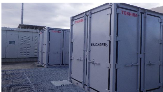
(写真1) 窒素ガス分離装置が設置されている コンテナ
