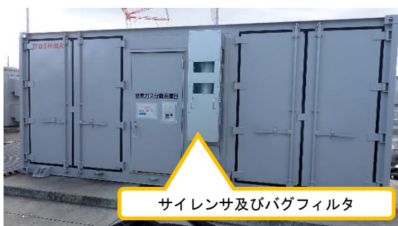
(写真3) サイレンサ及びバグフィルタ
