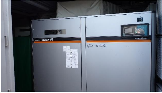
(写真4) 空気圧縮機の状況
