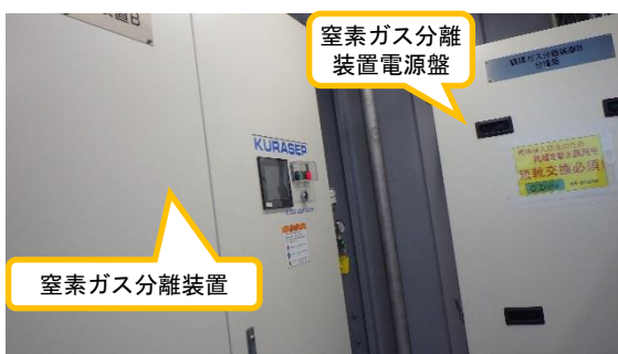
(写真2) 窒素ガス分離装置が設置されている コンテナ内部の状況
