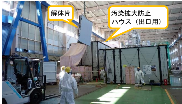
(写真3-1) 除染処理終了後のクレーンによる解体片の仮置き作業状況
