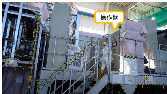
(写真2) 大型機器除染設備操作盤による設備の操作状況
