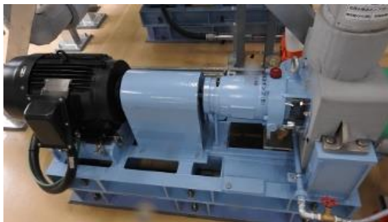
(写真1-2) 処理水移送ポンプ (B) の状況②
