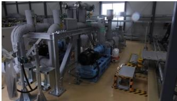
(写真1-1) 処理水移送ポンプ (B) の状況①
