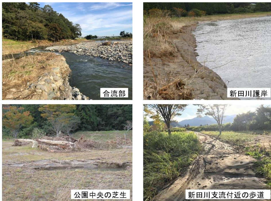
図 3 台風後の河川公園 A の状況
