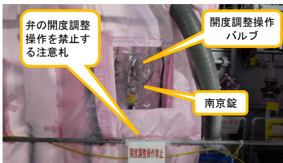
(写真 3) 注意札の掲示、南京錠による弁固定の状況
