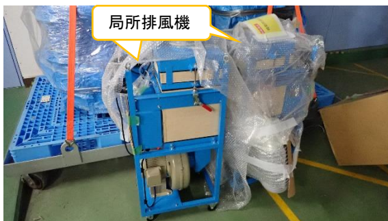
(写真1-2) 可搬式設備 (PCVガス管理設備排気ファンの代替設備として整備した局所排風機 (2基)) の保管状況
