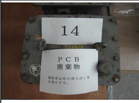
④変圧器(トランス)14
