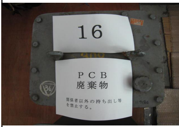
⑥変圧器(トランス)16
