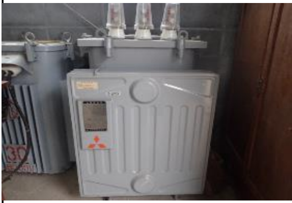
①変圧器(トランス)31-003
