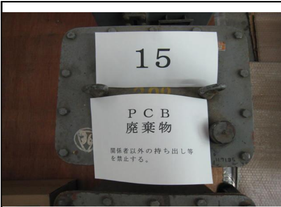
⑤変圧器(トランス)15
