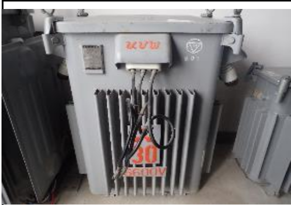
②変圧器(トランス)31-004
