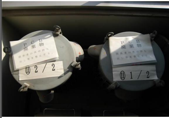
①変圧器(トランス)11-1
