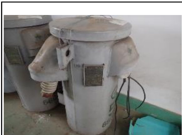
④変圧器(トランス)31-006
