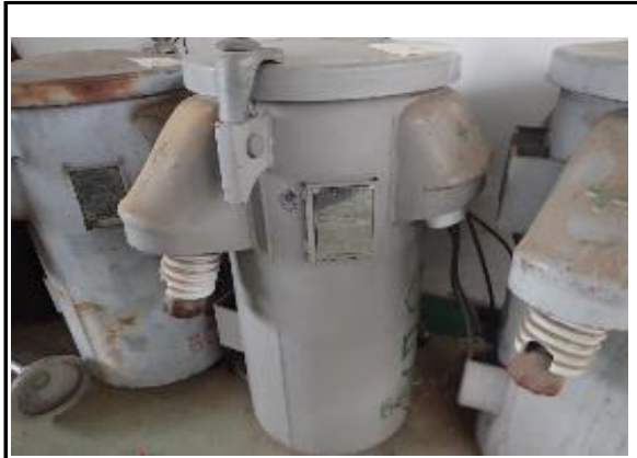
③変圧器(トランス)31-005
