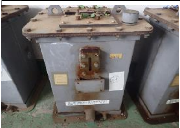
⑧変圧器(トランス)31-010
