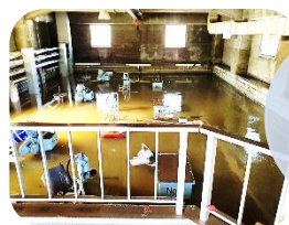
台風による 取水場浸水
