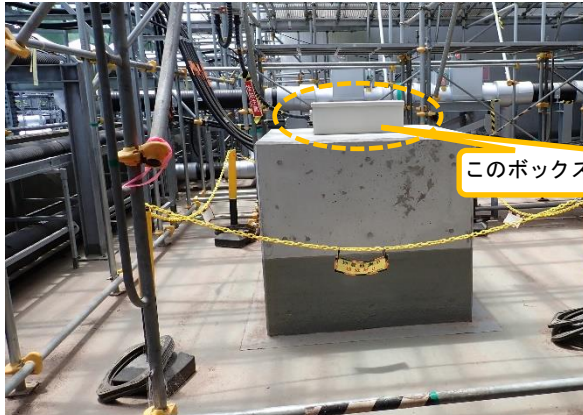
(写真1-2) K4タンクエリア内の地震計 (エリア北東側：A10タンク脇)
