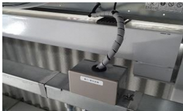
図8 忌避剤を含むスパイラルチューブで保護されたケーブル
