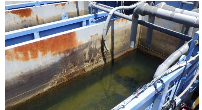
浸出液処理水槽
