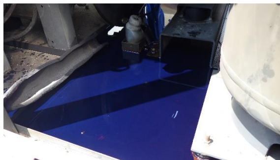
(写真3①) ポンプからの油漏れ
