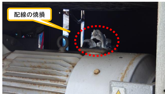
(写真2①) モーター配線の焼損
