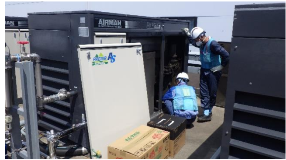
(写真1②) コンプレッサーC 外観
