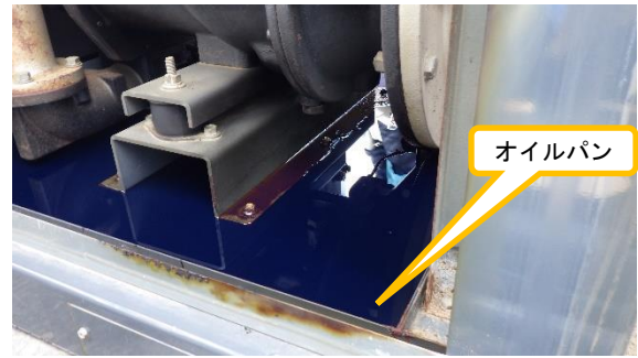
(写真3②) ポンプからの油漏れ
