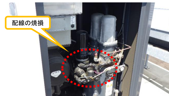
(写真4①) ポンプ配線被覆カバーの変形
