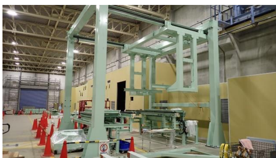
(写真2) 定検機材倉庫B中央部の状況 (切断及びFRP剥離ブース) (東側を向いて撮影)
