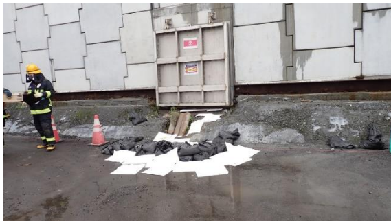
(写真4①) 防潮堤フラップゲート②海側出口付近における確認作業状況
