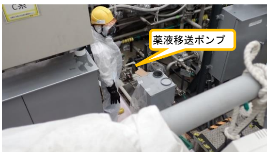
(写真1-2) クロスフローフィルターへの送液状況 ※硝酸をポンプで送液している。
