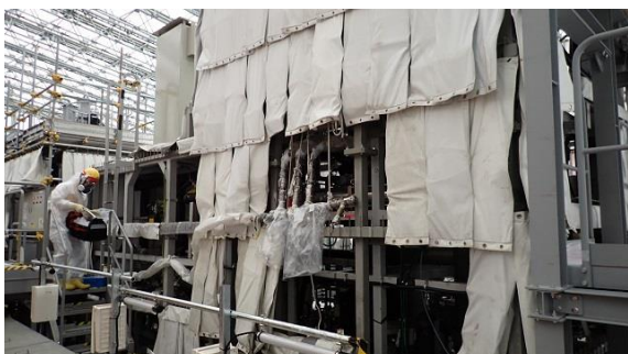
(写真1-1) クロスフローフィルターの設置状況 ※被ばくを低減するために遮蔽シートで覆われている。
