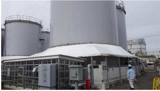
(写真 1 ①) J2、J3雨水回収タンク (700m 3 × 2基)
