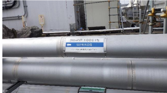
(写真 2 ②) J2・J3雨水回収タンク からの散水ライン
