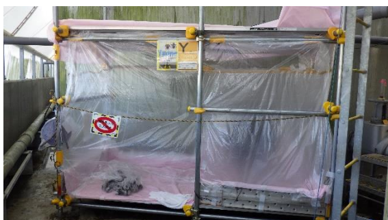
(写真1-3) タンク内残水移送作業のためJ9-A4タンク側面マンホールに設置された装備交換場の設置状況
