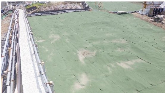
(写真5-1) 防火帯の状況① ※6号機北側の状況を西側から撮影
