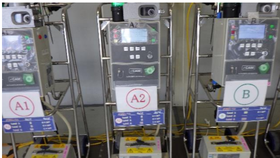
(写真2-1) 連続ダストモニタの設置状況
