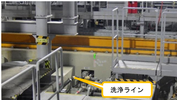
(写真2-1) 洗浄ラインの敷設状況 ※写真奥に吸着塔、手前にバッファタンクが設置されている。
