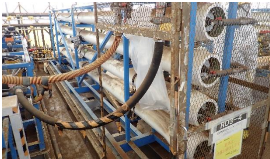
(写真1-3) 逆浸透膜の処理ユニットの設置状況 ※淡水化装置RO3の一部
