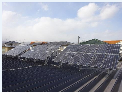
【屋上設置の太陽光パネル】
