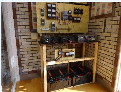
【事務所内にある充電設備】
