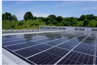
【太陽光パネル】
