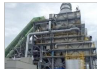
仮設焼却施設
