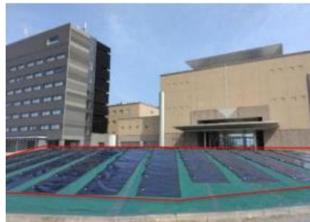
ビレッジでの実証（福島県楢葉町） 出典：資源エネルギー庁
