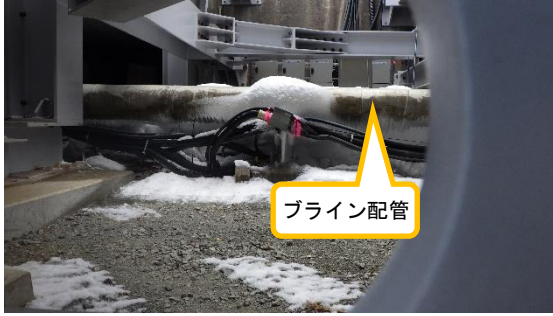
(写真2) ブライン供給配管の状況 ※保護カバー内の様子を撮影
