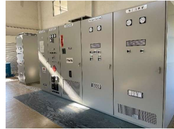
汚泥棟電気設備 (高圧引込盤、高圧受電盤、主変圧器盤、低圧動力主幹 盤、電灯主幹盤など)
