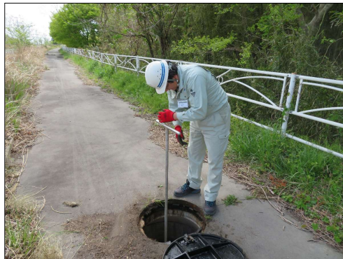
一斉定期点検の様子
