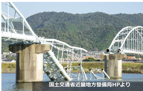
国土交通省近畿地方整備局HPより 和歌山市 六十谷水管橋崩落事故
