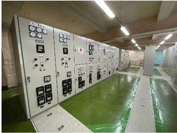
管理棟電気設備 (受電盤、変圧器一次盤、動力変圧器盤、動力分岐盤、 直流電源装置など)
