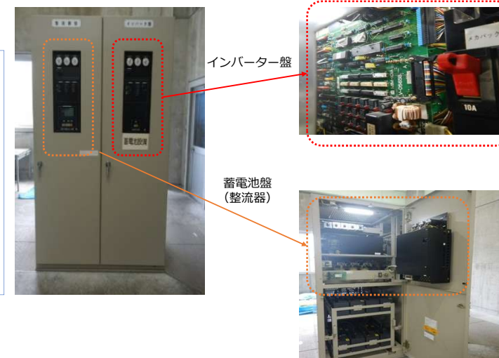
無停電電源装置蓄電池設備
