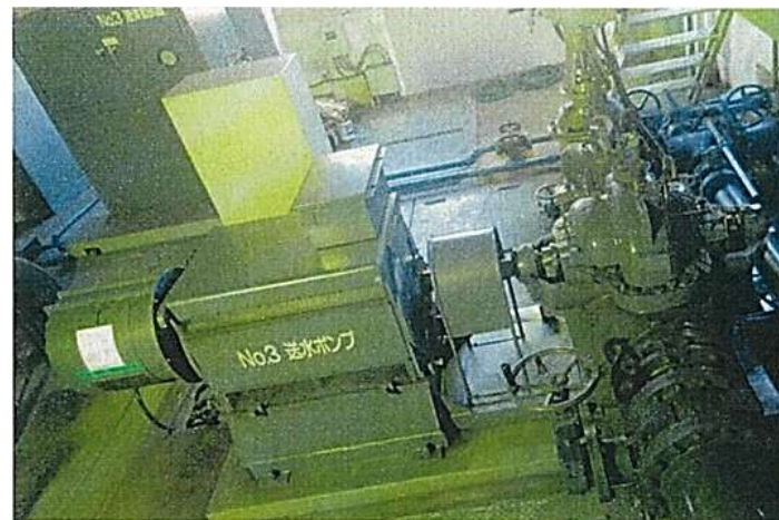
ポンプ本体（3号機）
