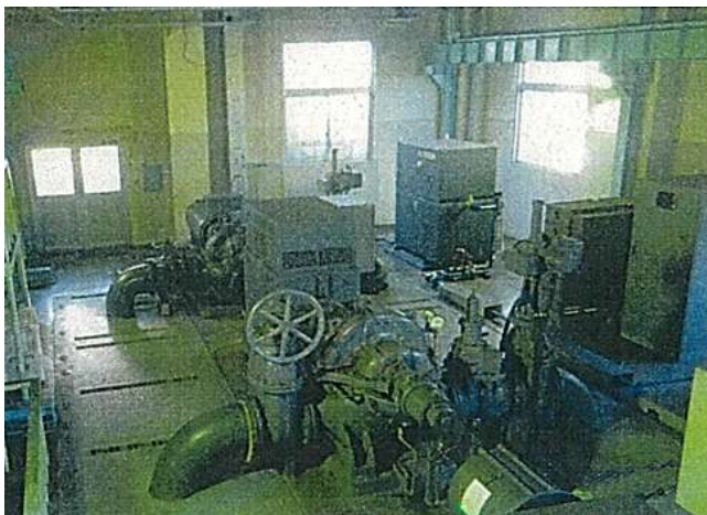
常磐ポンプ室
