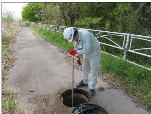
一斉定期点検の様子
