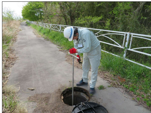
一斉定期点検の様子
