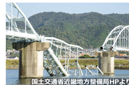
国土交通省近畿地方整備局HPより 和歌山市 六十谷水管橋崩落事故
