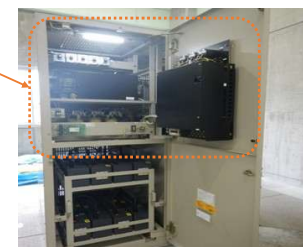
無停電電源装置蓄電池設備
