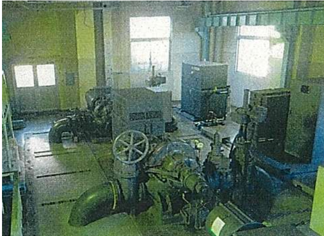
常磐ポンプ室
