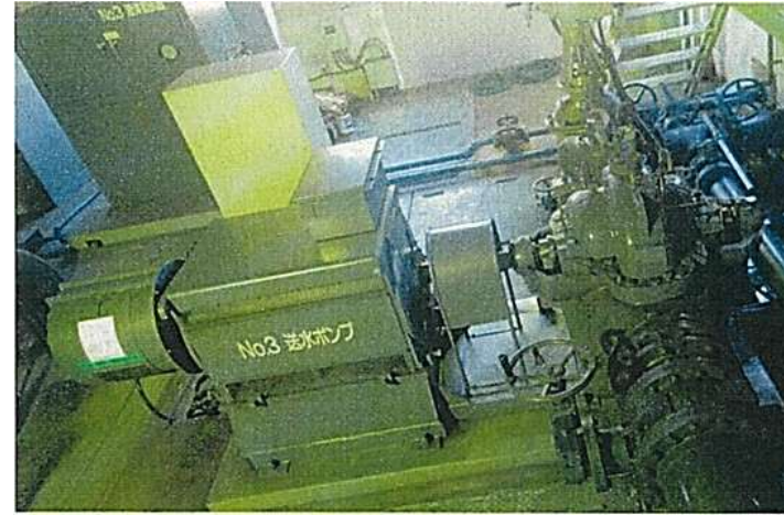
ポンプ本体（3号機）
