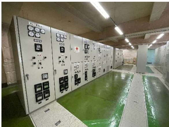
管理棟電気設備 (受電盤、変圧器一次盤、動力変圧器盤、動力分岐盤、 直流電源装置など)
