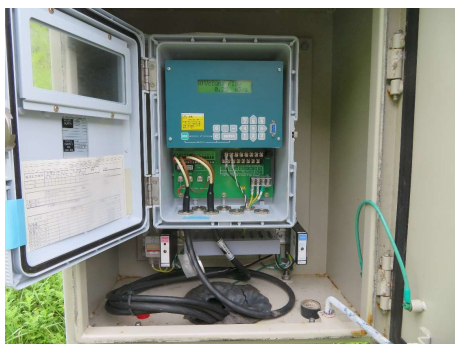
配水池流量計 (変換器)
