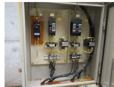
引込開閉器盤
