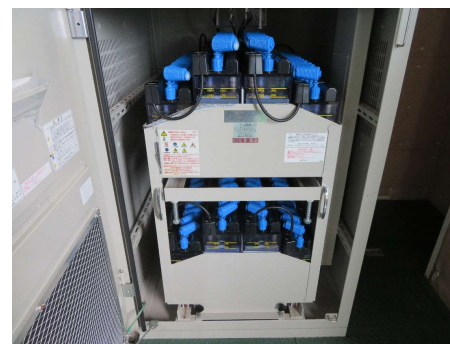
直流電源装置
