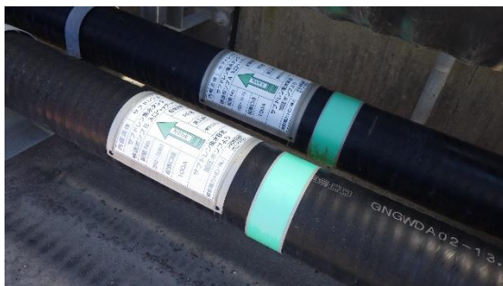
(写真 3 ①) 移送配管の様子①
