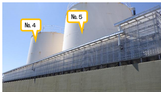
（写真1②）集水タンクNo. 4及び5
