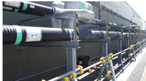
(写真 3 ②) 移送配管の様子②
