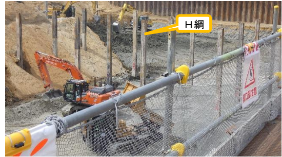
(写真 2 ②) 土砂の掘削及び搬出状況 ② ※南東側から撮影
