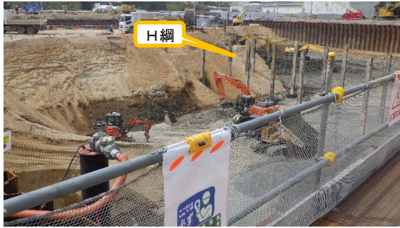
(写真 2 ①) 土砂の掘削及び搬出状況 ① ※南東側から撮影
