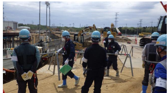
(写真 4 ②) JVによる建設現場安全 確認の合同パトロール実施状況②
