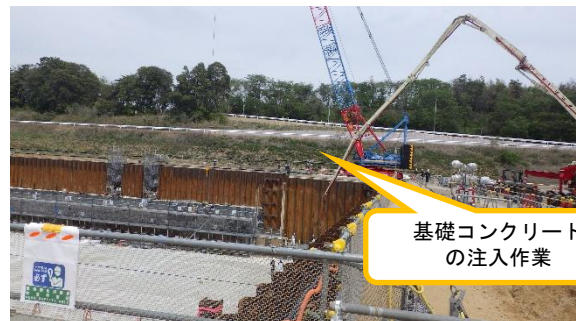
(写真1④) 第11棟搬入口予定箇所 周辺部におけるコンクリート打設
