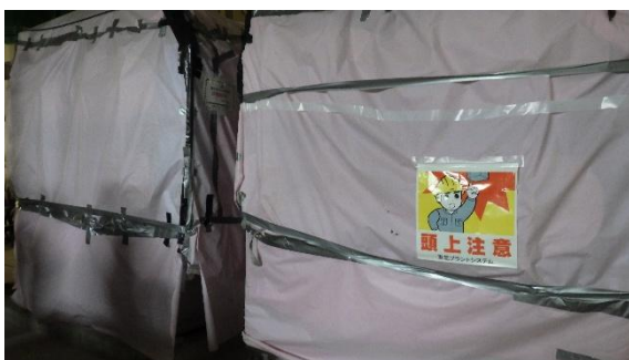
(写真7-1) フィルタユニットの設置状況
