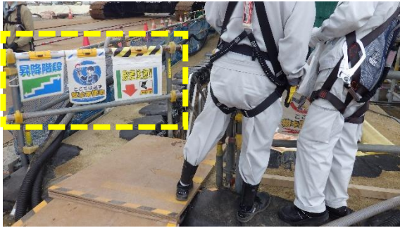
(写真 8 - 1) 現場の安全対策に係る掲示の例①
