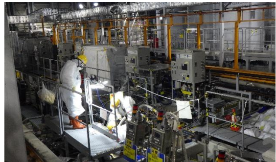
(写真3-2) 増設ALPS建屋内の メンテナンス作業② (アンカー打設)
