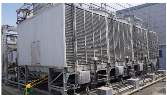
(写真5②) 冷却塔
