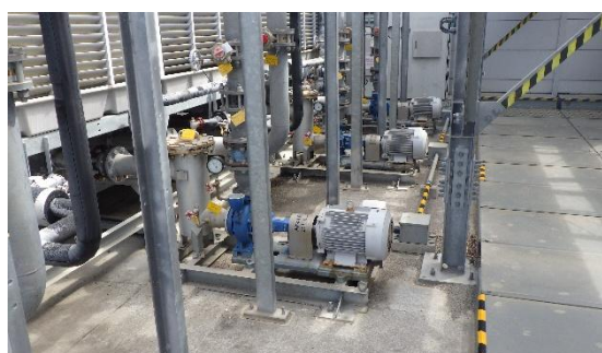
(写真5①) 冷却水循環ポンプ
