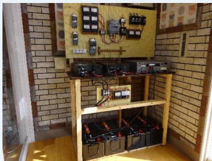
【事務所内にある充電設備】
