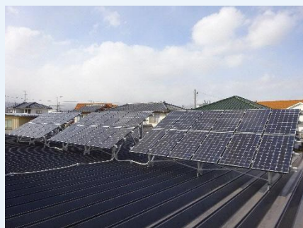
【屋上設置の太陽光パネル】
