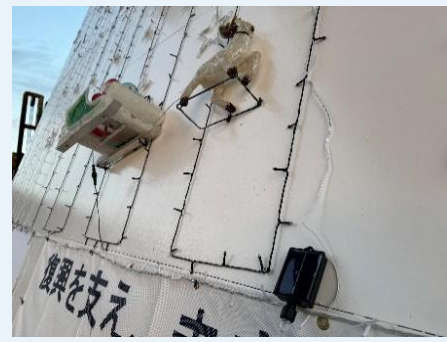
【太陽光パネル蓄電池を利用した電飾】
