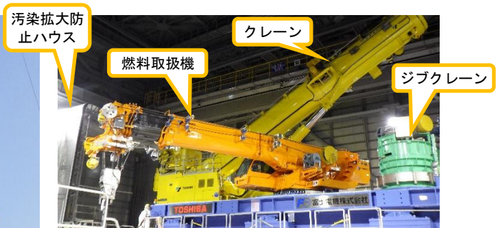
(写真2①) 燃料取扱設備の設置状況
