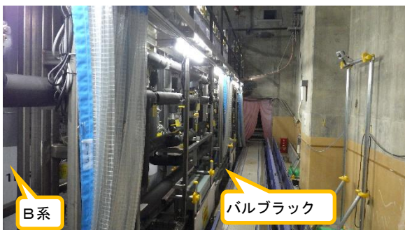
(写真2-2) SARRYのバルブラックの設置状況② (吸着塔 (B系) の裏側から撮影)
