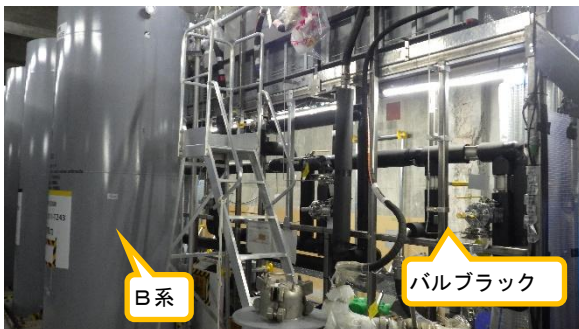
(写真2-1) SARRYのバルブラックの設置状況① (吸着塔 (B系) 側から撮影)
