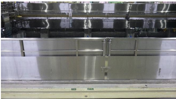
(写真5-2) 共用プールの水面の状況
