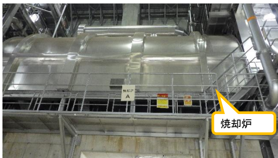
(写真1-1) A系設備（焼却炉等）の状況
