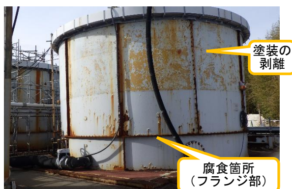
(写真2) F2タンクエリアC群のタンク（フランジ型タンク）の腐食状況
