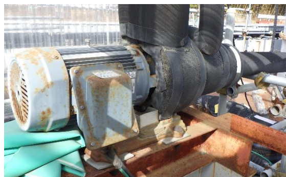
(写真4) 滞留水の移送ポンプ（使用済み）の保管状況
