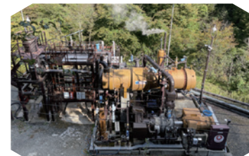
震災時の停電の経験からスタートしたバイナリー発電所
