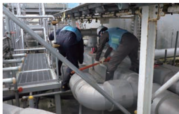
地下水バイパスにより汲み上げられた地下水放出時のタンク弁開閉作業の状況（令和7（2025）年9月時点、福島県撮影）
