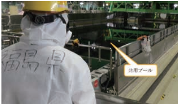
ライナドレン流量高の警報が発報した共用プールを確認する県職員（令和7（2025）年6月12日、福島県撮影）
