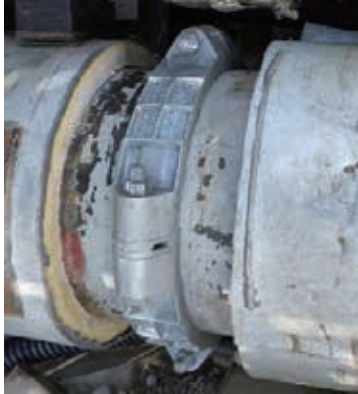
令和4（2022）年にブライン（不凍液）が漏えいしたブライン供給配管のカップリングジョイント部
