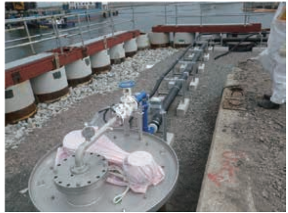
海側遮水壁と地下水ドレンポンド
