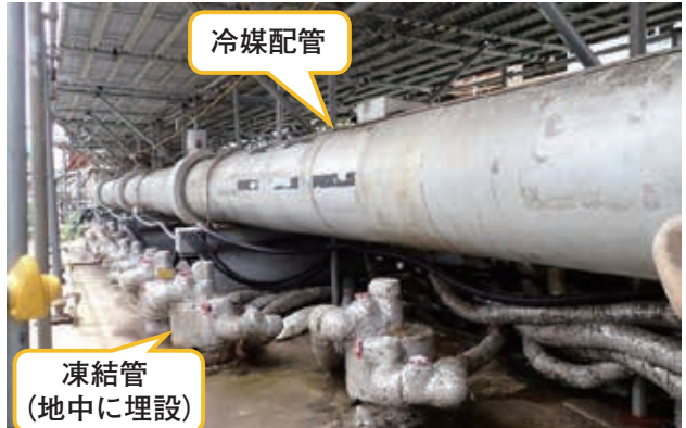
陸側遮水壁の冷媒配管及び凍結管（地中に埋設）の稼働状況（令和7（2025）年6月時点、福島県撮影）
